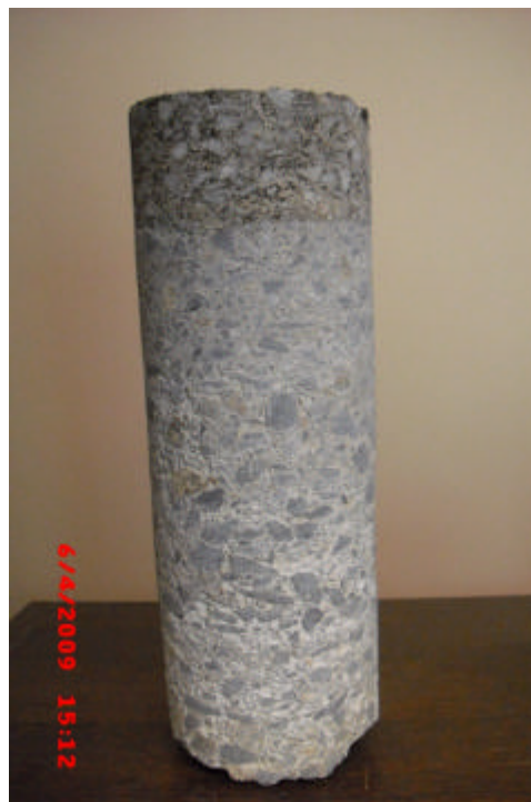
Figure 7 : échantillon prélevé par carottage pour le calage des épaisseurs (zone située entre les deux bandes de roulement) PK 1599.
